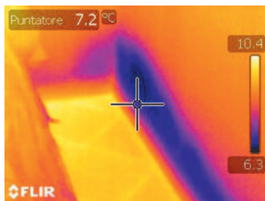
Umidità capillare in una muratura
