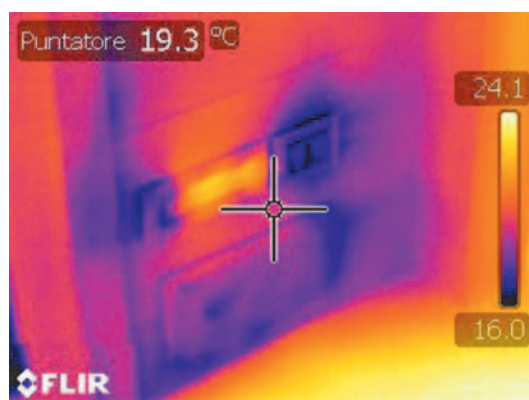
Infiltrazioni d'aria dalle scatole dell'impianto elettrico
