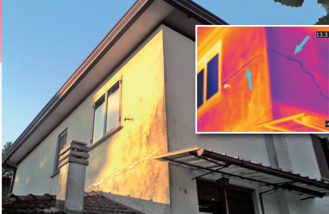
Importante lesione strutturale evidenziata
