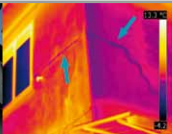
Lesione evidenziata dalla termografia
