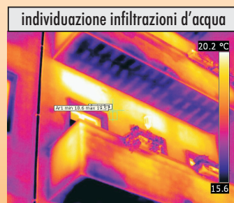
problemi di infiltrazione d'acqua ed umidità su terrazzi di condominio
