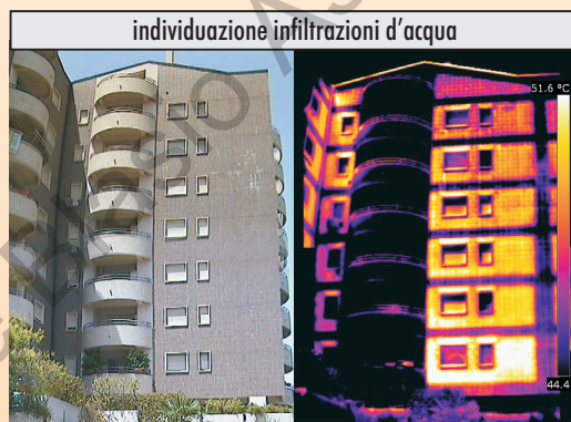
termografia della facciata di un condominio con problemi di infiltrazione d'acqua e distacco piastrelle
