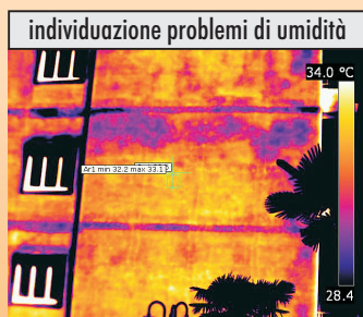
grossi problemi di umidità su facciata di condominio
