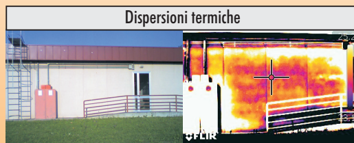
capannone industriale in cui la termocamera evidenzia problemi di isolamento
