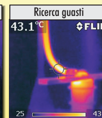
guasto in una giunzione elettrica
